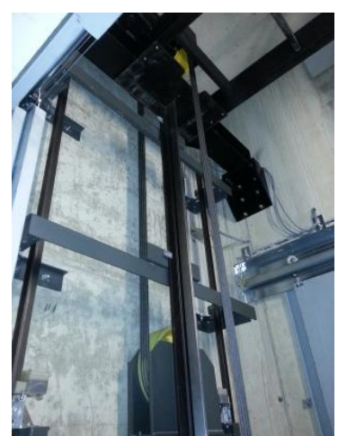
Aufzugsantrieb im Schachtkopf
