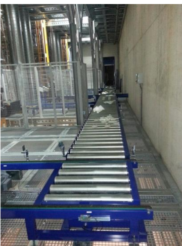
Förderstrecke Vorzone HRL
