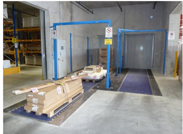
Sonderpaletten auf der Einförderstrecke
