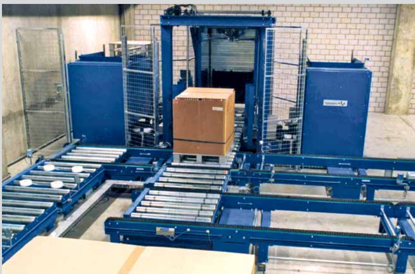
Bild 1: Übersicht der Anlage
